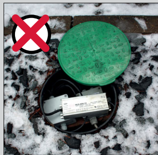
Netzteil ungeschützt im Bodenschacht Power supply unprotected inside the ground shaft Source d'alimentation sans protection dans un puits au sol
